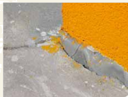
Fot. 6b. Taras nad pomieszczeniem – błędy przy wykonaniu jastrychu dociskowego – brak dylatacji obwodowej oraz złe wykonanie detalu uszczelnienia przy ścianie. Uniemożliwia to poprawne uszczelnienie dylatacji obwodowej (fot. autor)
