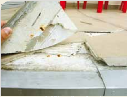
Fot. 8. Skutki błędów w obsadzeniu obróbek i klejeniu płytek (fot. autor)
