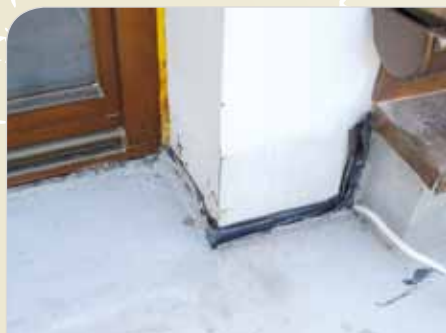
Fot. 7a. Taras nad pomieszczeniem – kilka błędów w jednym miejscu – brak dylatacji obwodowej, bezmyślne wywiniecie papy na ścianę, znacznie utrudniające uszczelnienie styku wylewka – ściana, brak możliwości skutecznego uszczelnienia styku przy progu drzwiowym (fot. autor)
