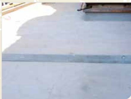
Fot. 7b. Taras nad pomieszczeniem - spękania wylewki na skutek braku dylatacji i brak spadków powierzchni tarasu (fot. autor)
