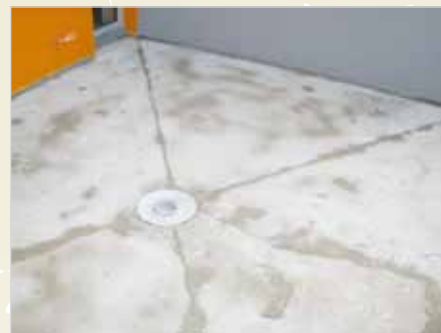
Fot. 6a. Taras nad pomieszczeniem – błędy przy wykonaniu jastrychu dociskowego – rezultatem jest spękanie wylewki (fot. autor)
