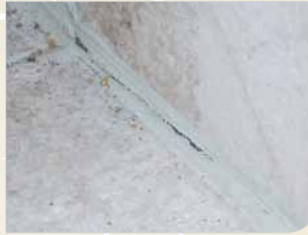
Fot. 9. Skutek błędów w wykonaniu dylatacji (fot. autor)
