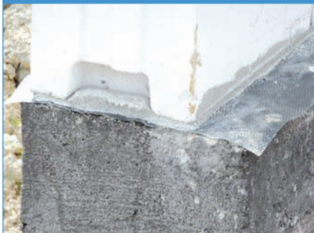
Fot. 1 – mury z elementów drobnowymiarowych (cegły, pustaki, bloczki itp.) muszą być otynkowane przed zaizolowaniem roztworami asfaltowymi (fot. autor)
