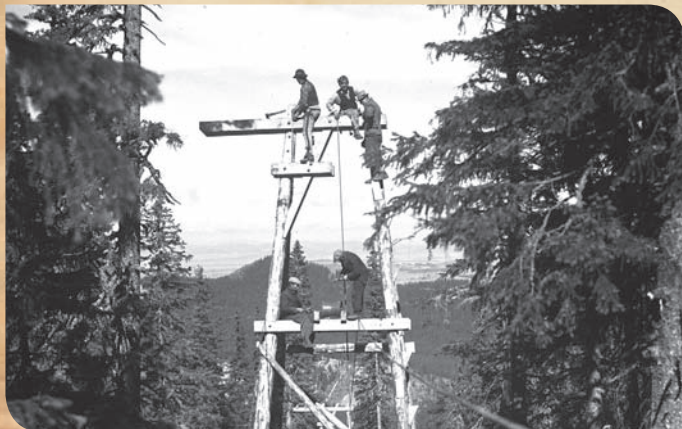
Drewniana podpora pomocniczej kolejki transportowej
